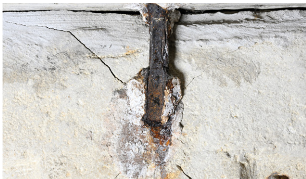
Eine der Eisenklammern unter der Deckplatte des Steinsarkophags. Deutlich erkennbar sind die vom korrodierenden Eisen ausgehenden Risse in der Seitenwand.
