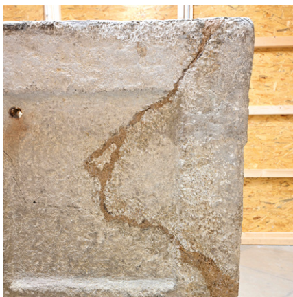
Die alt ausgebrochene Ecke des Sarkophags nach Abnahme des aus heutiger Sicht nicht zweckdienlichen zementhaltigen Mörtels.
